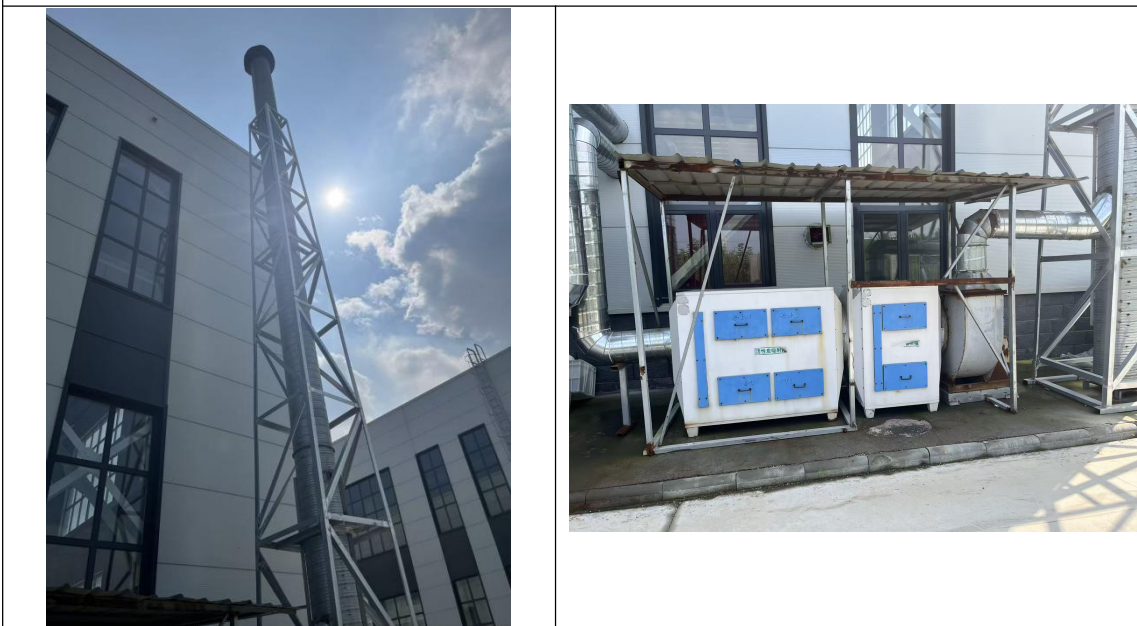
滴漆废气处理装置
