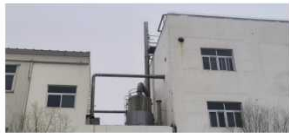
液体车间治理设施
