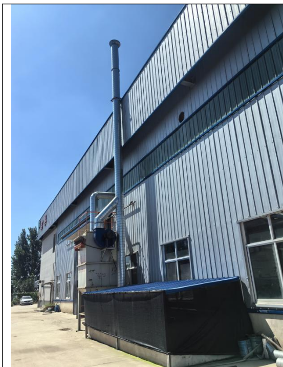
布袋除尘器+15m 排气筒 (DA001)
