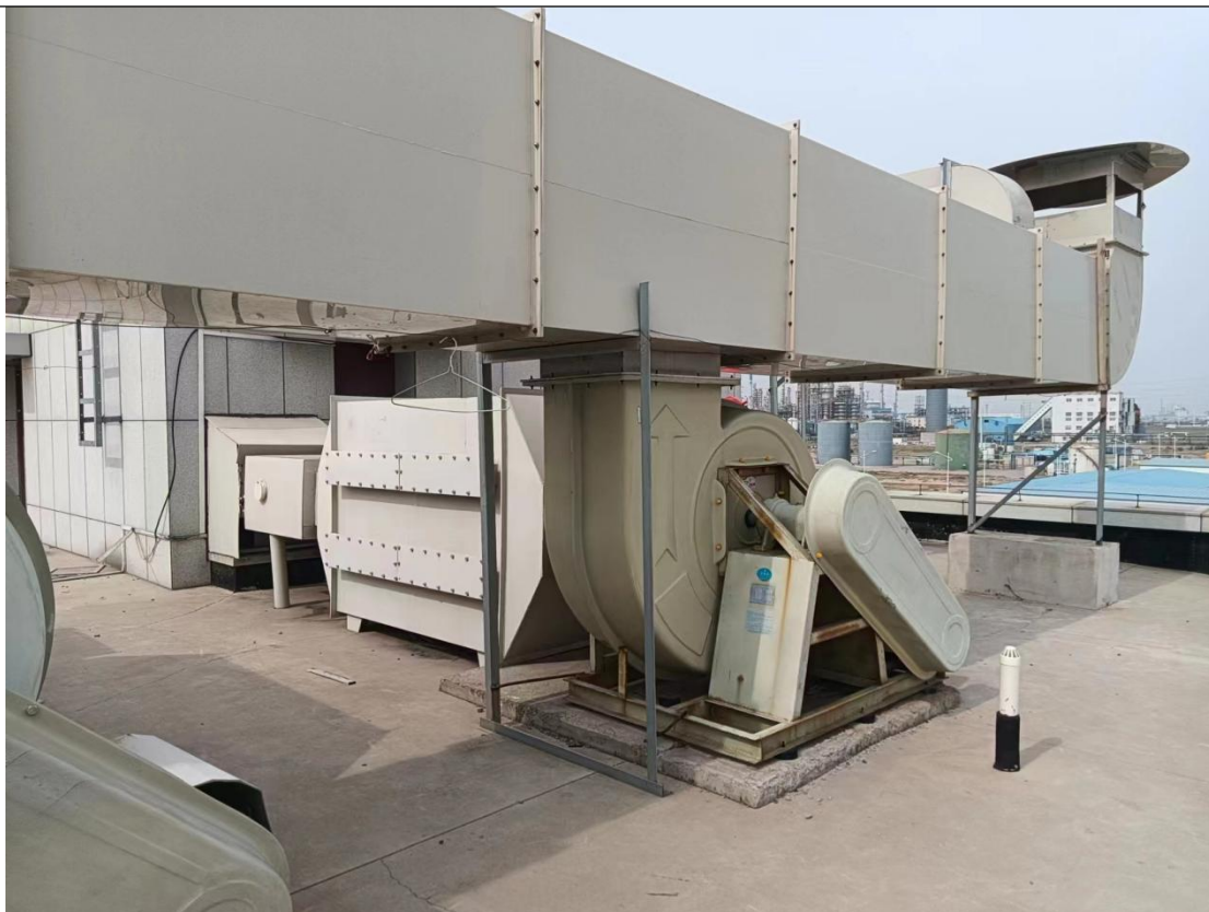
实验室东北部设备经活性炭处理
