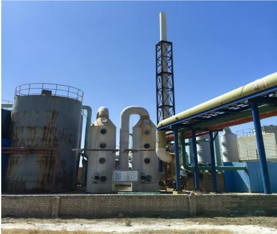
两级碱喷淋+25m 高排气筒(DA022)
