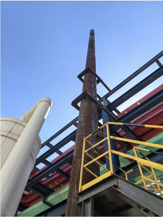
25m 高排气筒 (DA024)
